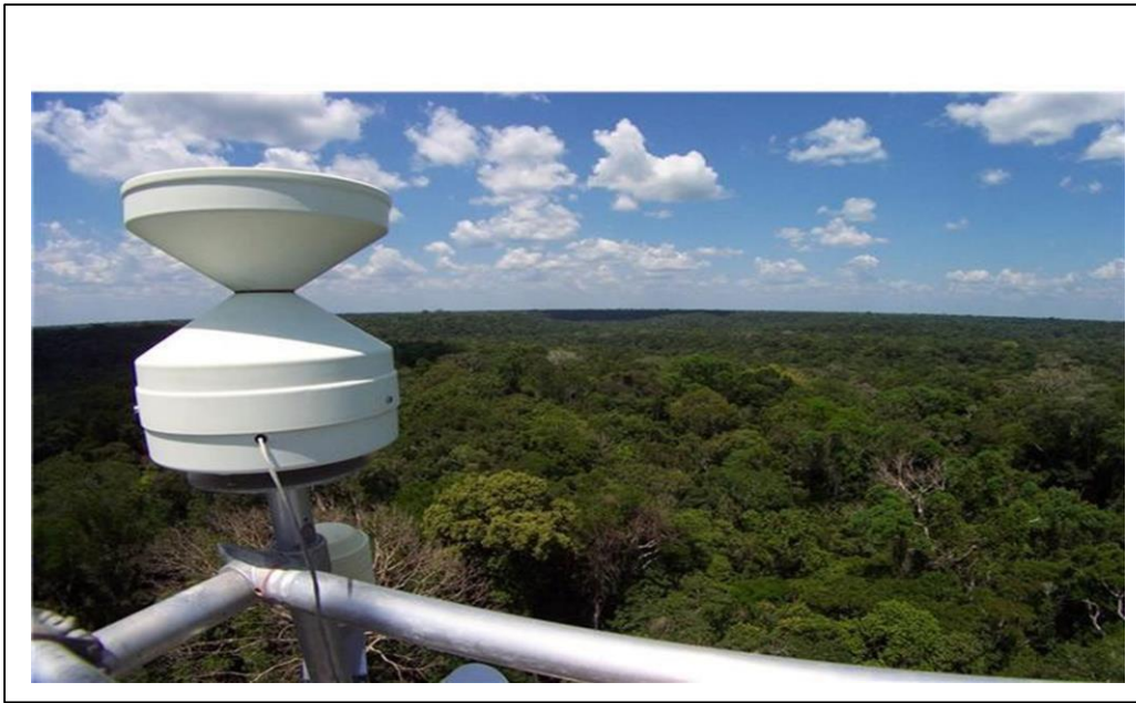
Figura 15 – Visualização do pluviometro EM – ARG 100 instalado na torre experimental K34, onde observa a grande distancia até o chão(51,3m) Fonte : http://lba.inpa.gov.br/fotos/?pag=LBA#
