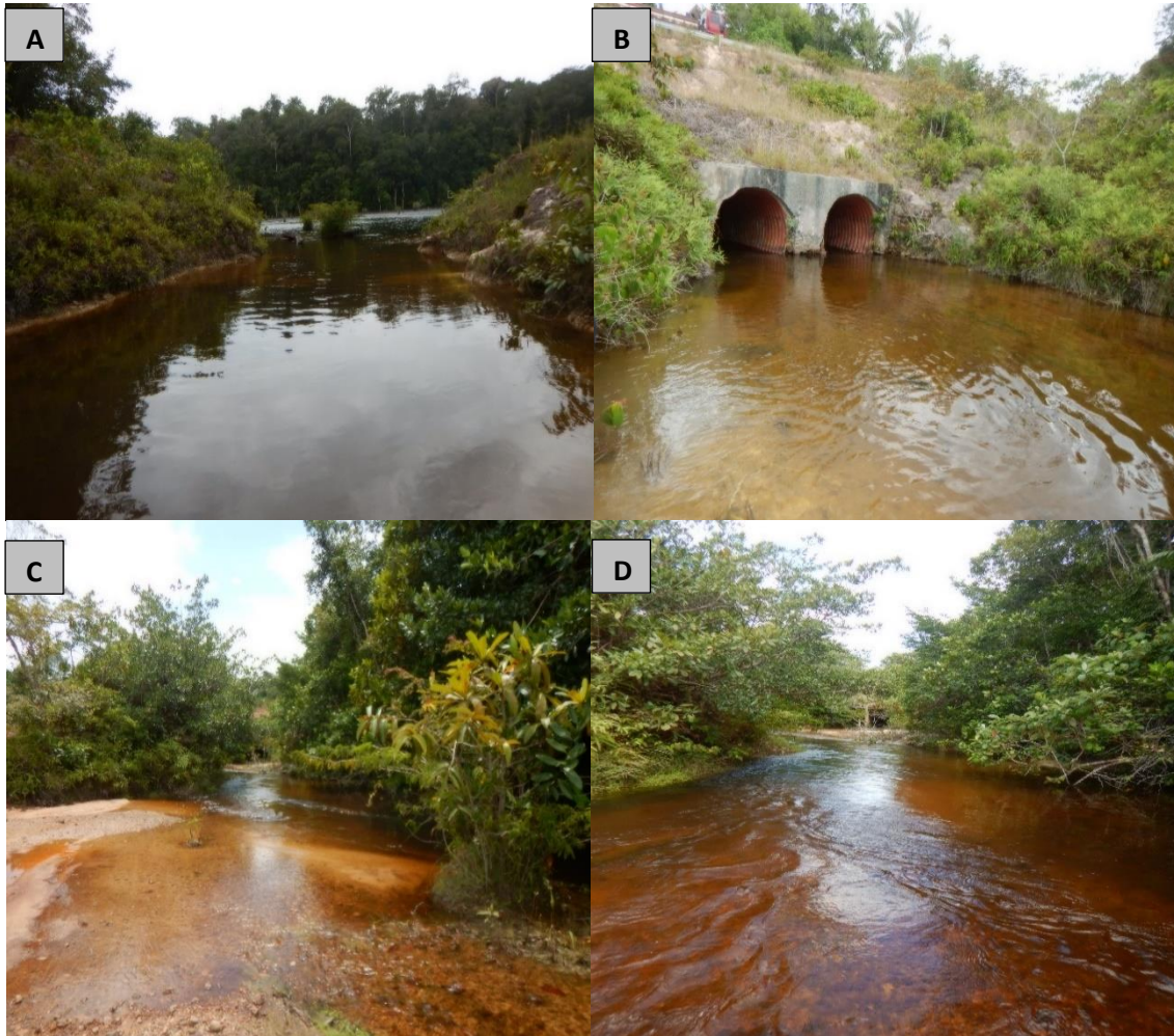
Figura 4. Igarapés alterados, interceptados pela rodovia BR-174 (AM). Caracterizado pela ausência de dossel, com montante alagada (A), presença de manilhas ou bueiros (B), seguida de trechos assoreados à jusante (C e D).
