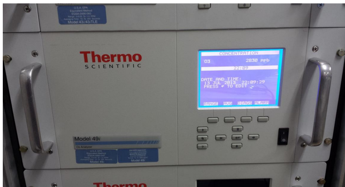
Figura 7 - Monitor de qualidade do ar Thermo, modelo 49i, instalado em Manacapuru/T3.
