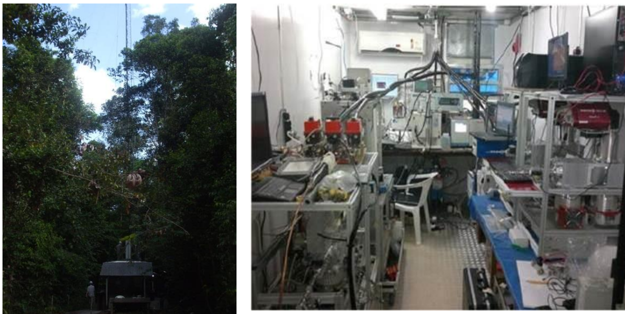
Figura 8 - Contêiner utilizado como plataforma de amostragem de aerossóis e gases na base da torre TT34 (esquerda) e arranjo experimental dos diferentes instrumentos dentro do contêiner (direita).
