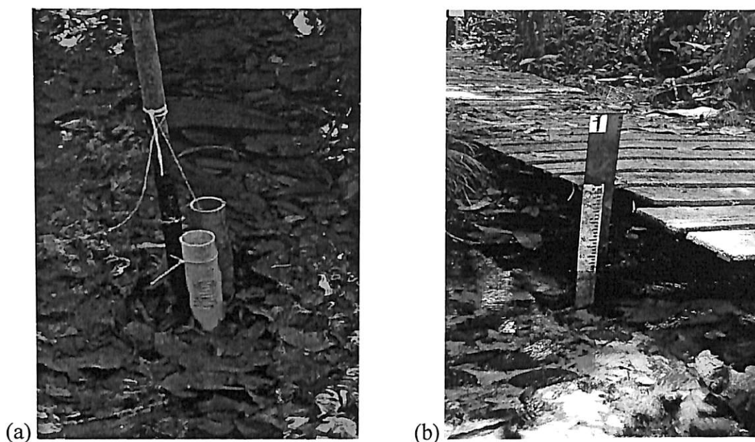
Figura 2. Sensor de pressão (a) e Régua Linimétrica (b), utilizados para medir o nível do igarapé.
