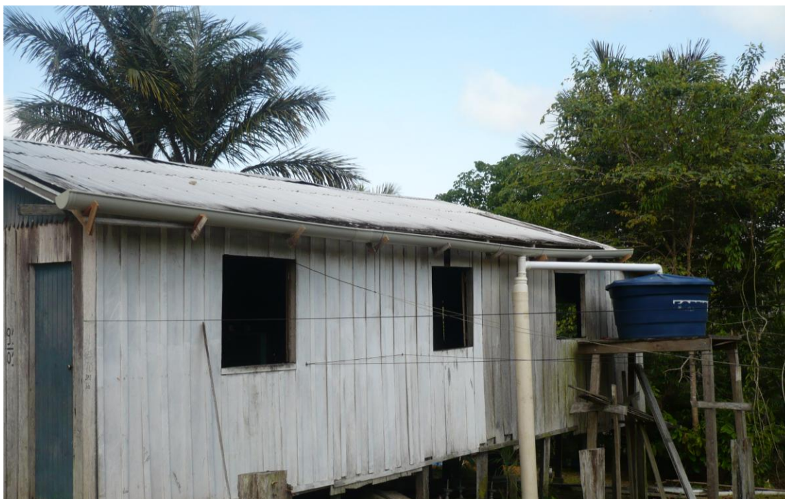
Figura 1 - Sistema de captação de água da chuva instalado em uma residência do Julião, Manaus-AM.
